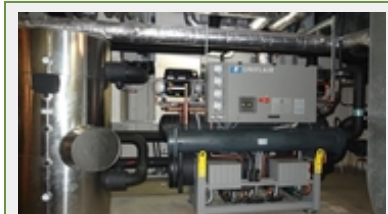
Turbinenverdichter CinemaxX Mannheim
